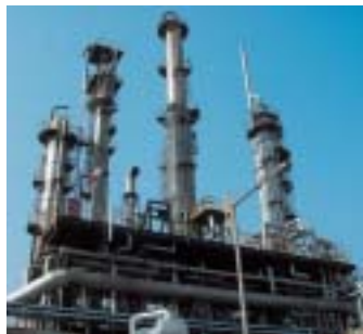
東西石油化学の AN 製造設備
