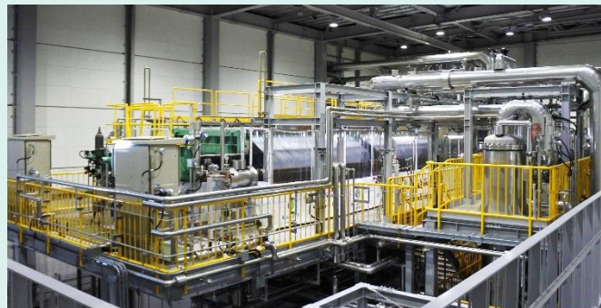
10MW級大型 アルカリ水電解システム
