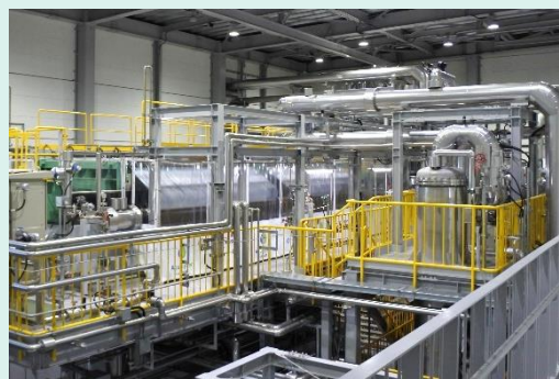
10MW級アルカリ水電解システム
